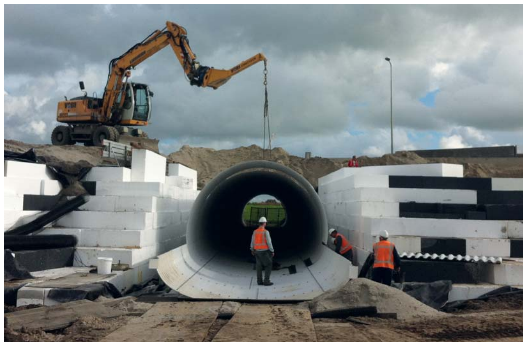
Figuur 3 – Monteren van de gegolfde staalplaten van de fietstunnel onder de Veilingroute (N222).
