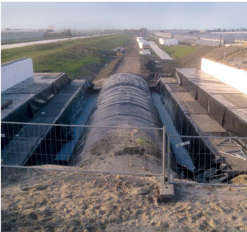
Figuur 4 – De afgedekte gegolfde staalplaten en het gedeeltelijk gestorte schuimbetonmassief van de fietstunnel onder de Veilingroute (N222).
